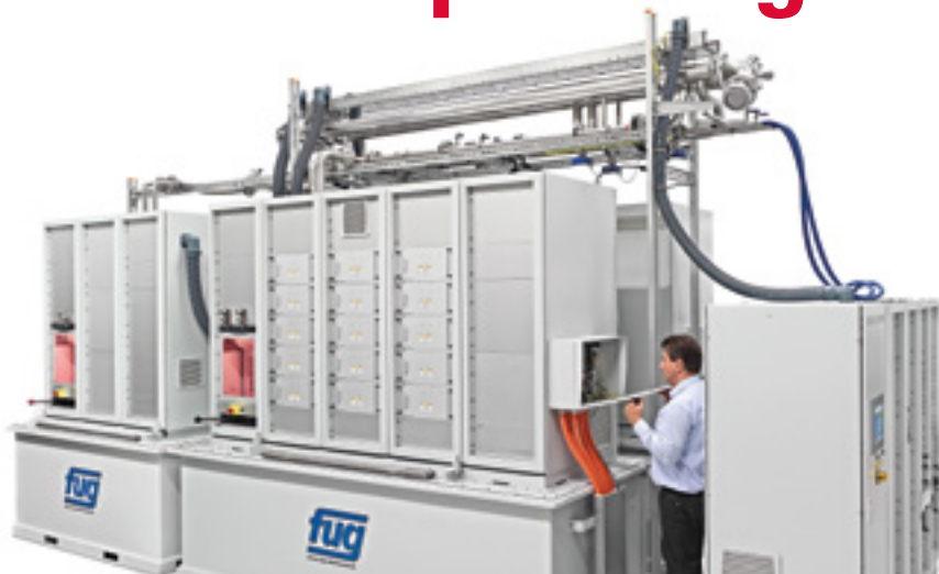
FuG Stromversorgungsgerät (600 kW, 40 kV) für einen Teilchenbeschleuniger beim BESSY in Berlin. Fenster und Spiegel dienen zur Sichtkontrolle von Öl und Schalterstellung bestimmter sicherheitsrelevanter Bauteile.
