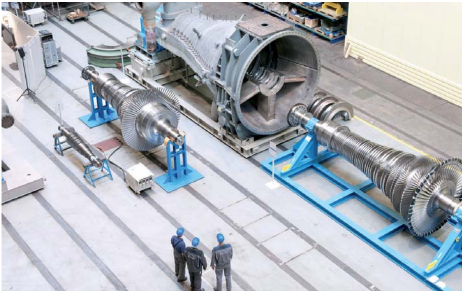
Auch in China gilt: Mit MDT PrimeServ erhalten Kunden Service aus einer Hand (z.B. Montage einer Dampfturbine).
